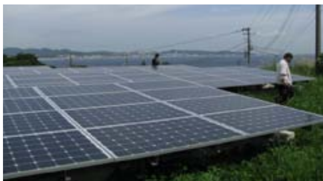
太陽光パネル
